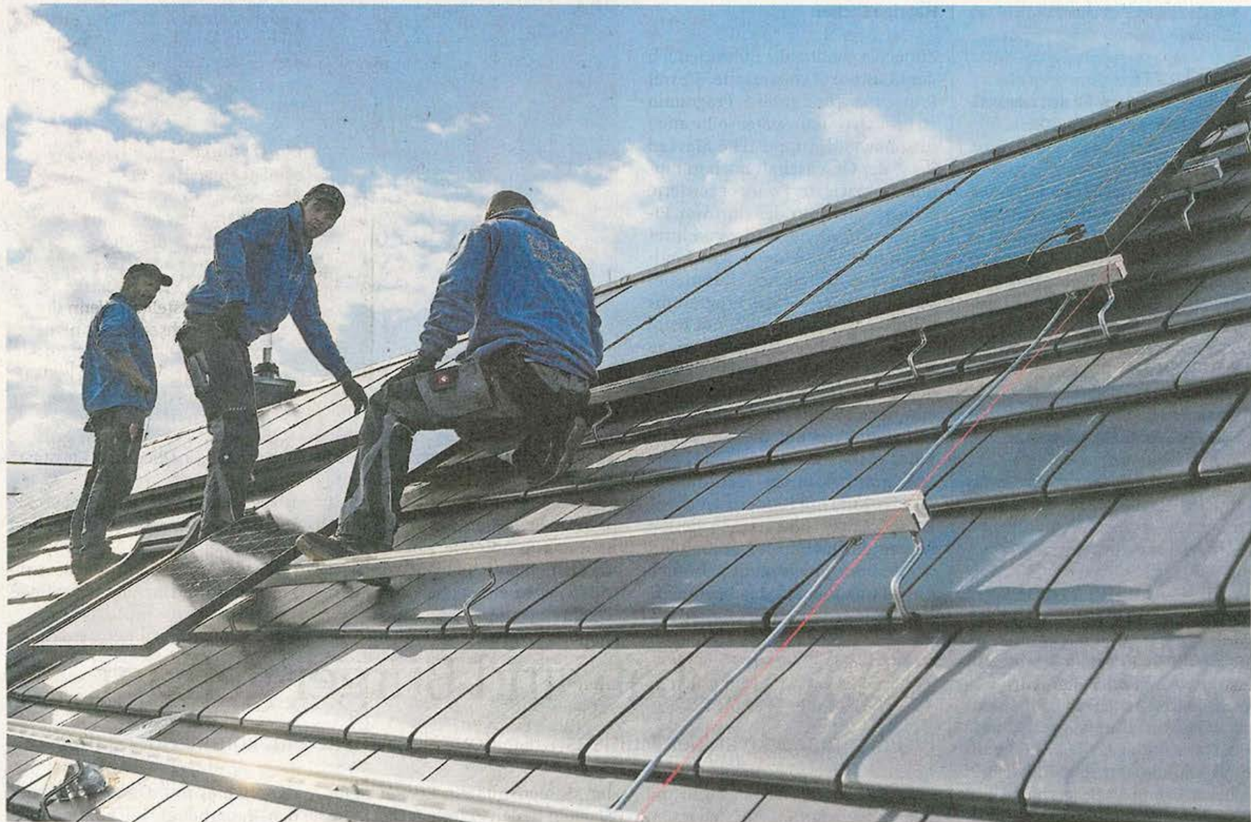
Die Monteure kommen den Wünschen ihrer Auftraggeber kaum nach. Der Bedarf an Solaranlagen und anderen alternativen Energieformen steigt derzeit auch in Heinsberg stetig an.
