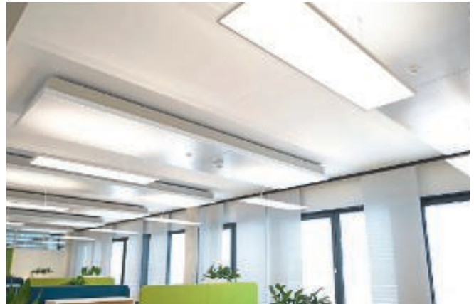
Die Deckensegel Smartline sind perforiert ausgeführt, zusätzliche Akustik-Volumenabsorber sorgen für eine erstklassige Raumakustik.
