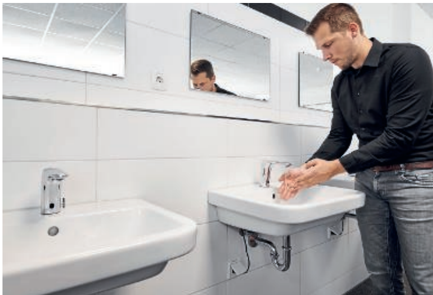
Der Erhalt der Trinkwasserhygiene kennt keine punktuellen Ansätze, sondern betrifft immer den gesamten Fließweg; hier bis zu den berührungsfrei auslösenden „AquaVip-Armaturen elektronisch“ für den Waschtisch.
