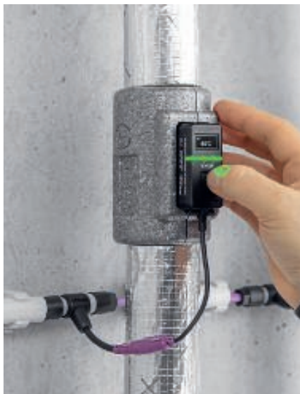
In Warmwasser-Zirkulationsleitungen ist die Temperaturhaltung 60/55 °C ein wichtiges Hygienekriterium. Über das „AquaVip-Zirkulationsregulierungsventil elektronisch“ wird dieses Temperaturfenster auch ohne genaue Kenntnis des Rohrleitungsnetzes zielführend unterstützt.
