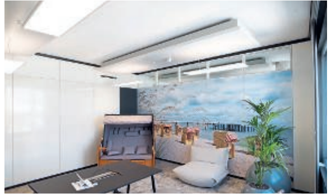
Pendelleuchten, Rauch- und Bewegungsmelder sind in die Deckensegel eingebaut.
