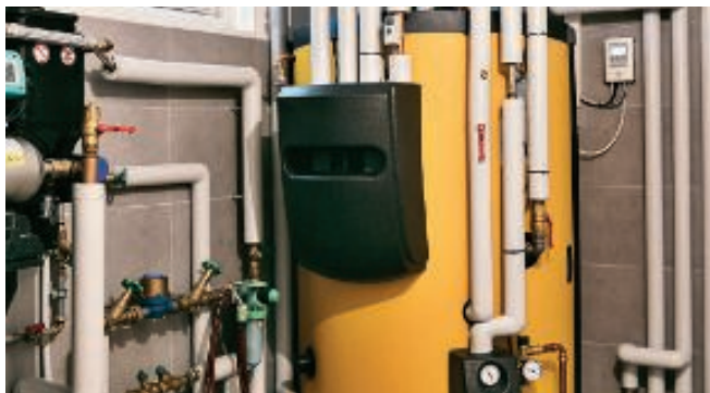
Familie Schmidbauer beheizt ihr 185 m 2 großes Haus mit einer Pellets-Solar-Kombi-Anlage von KWB. Auf dem Dach ist eine PV-Anlage. Die Wärmequellen verbindet ein Pufferspeicher, der mit dem KWB-EmpaFresh-Frischwassermodule ausgestattet ist.
